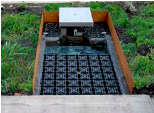
Wassereinlagerungen / Polderdak Apartmentkomplex De Boel, Amsterdam. Regenwasser wird gesammelt, gespeichert und in einer Pufferschicht wiederverwendet. Sensoren messen und steuern den Wasserstand und den Abfluss.
